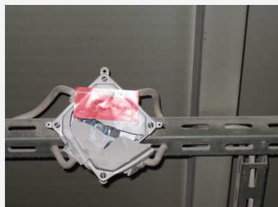
Fot. 2 Puszka elektryczna na wydziale pras
